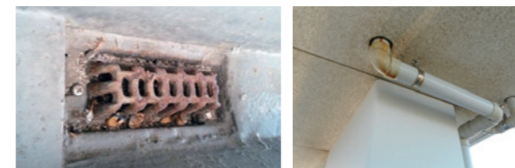
従来の鋳鉄製ドレン(左)と雨樋への錆汁状況(右)
