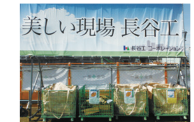
リサイクルヤードの設置状況
